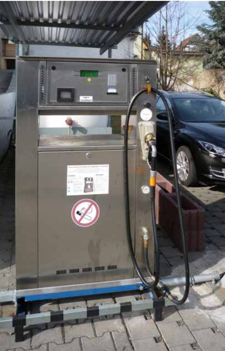
Autogastankstelle mit Explosionsschutz, der in das Nachbargrundstück ragt
