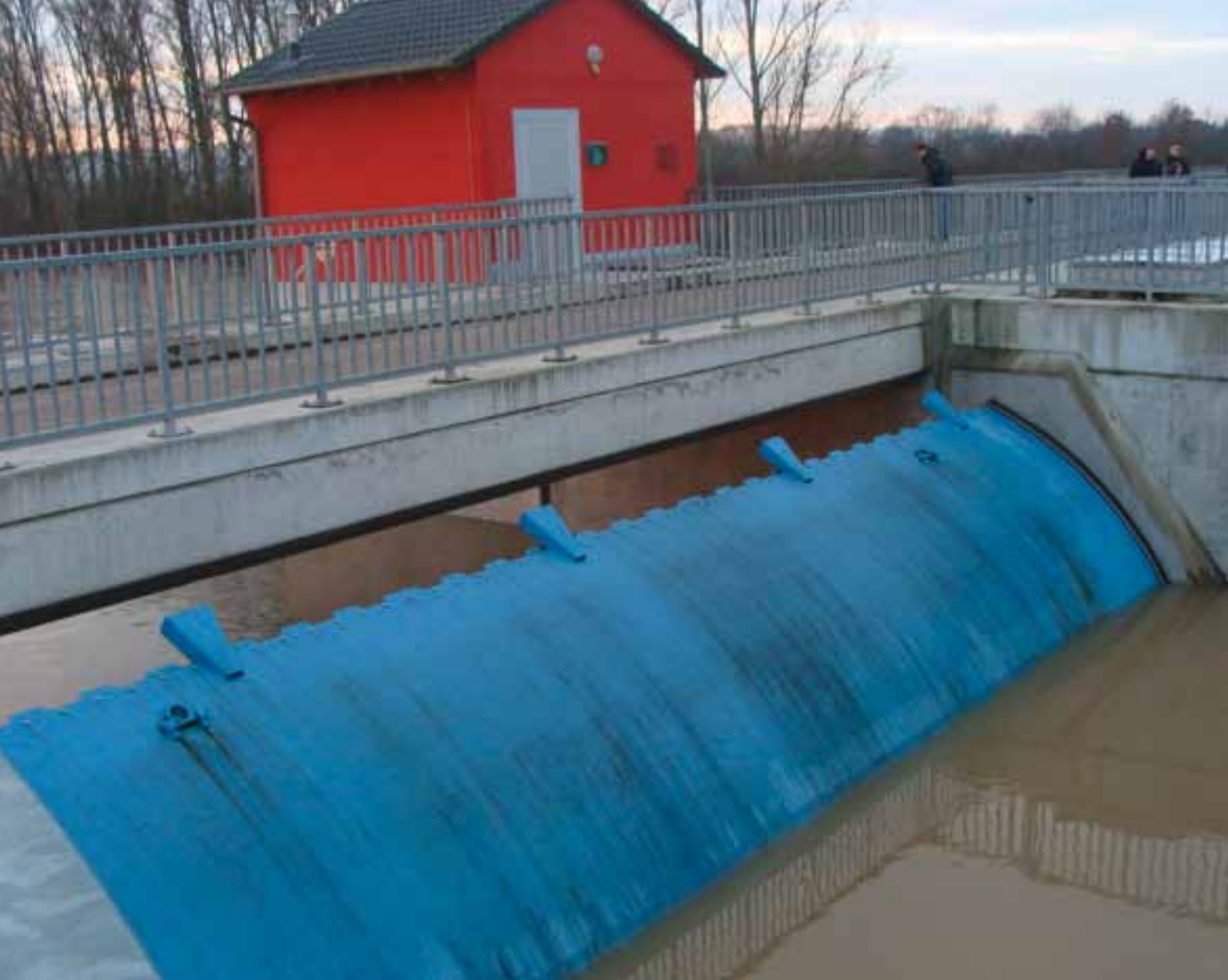
Fischbauchklappe zur Flutung geöffnet
