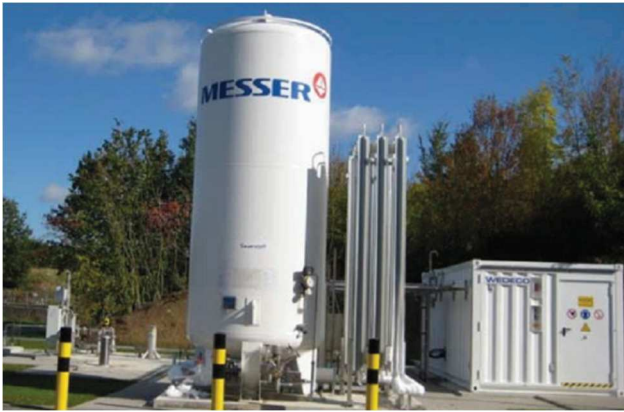
Abbildung 33: O 2 -Tank und O 3 -Generator
