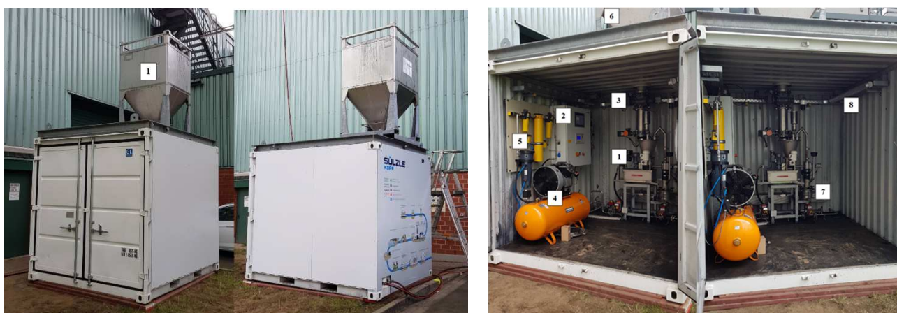
Abbildung 44: Beispiel einer PAK-Dosieranlage (Typ. AK-Dos, Fa. Sülzle-Kopf) von außen (links) und Innen (rechts)
