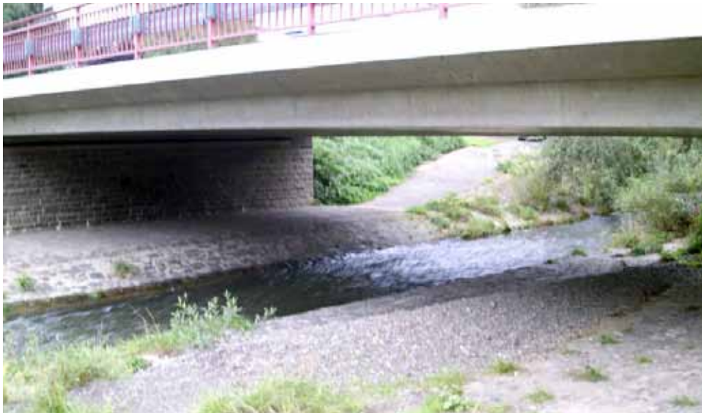
Abb. 38: Messstelle Elzbach Mündung Mosel
