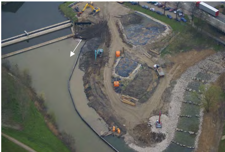
Abb. A.14: Fischaufstiegsanlage Hambeek in Roermond während des Baus. Der Einstieg wurde gezielt neben dem Wehr angeordnet
