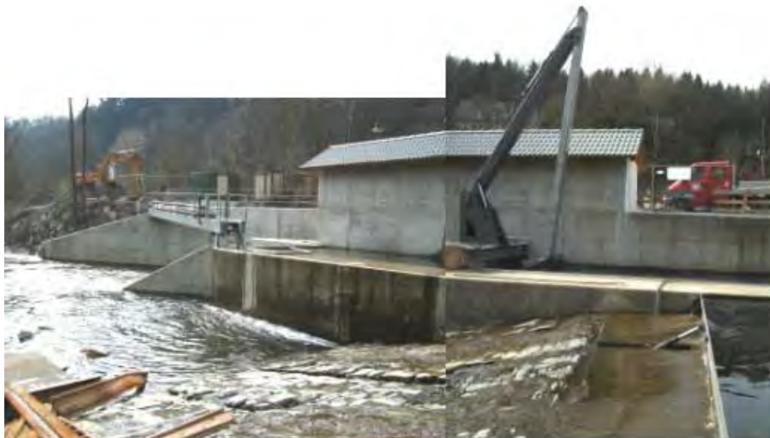
Abb. B. 9: Gesamtansicht der WKA Sigambria, Blick vom Wehr. Der Zulauf zur Turbine und der Rechen befinden sich zwischen Trennwand und Zugangsgebäude. Der Unterwasserauslauf liegt links.
