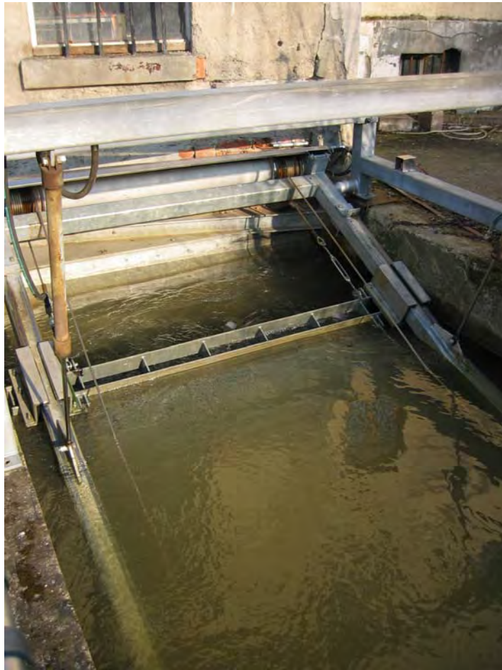
Abb. B. 7: Feinrechen mit Spülrinne und Harke der Rechenreinigungsmaschine
