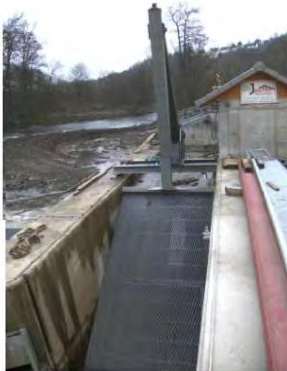
Abb. B. 13: Der flach geneigte 15 mm – Rechen und die Rechenreinigungsmaschine vor der Flutung der Anlage.
