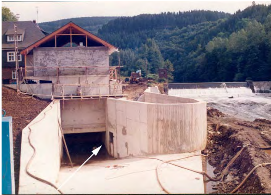
Abb. A.31: Unterwasserseitige Ansicht einer im Bau befindlichen Wasserkraftanlage an der Sieg (Rheinland-Pfalz, 1985). Rechts ist neben dem Saugrohraustritt der Einstieg in die Fischschleuse erkennbar. Die Schleuse ist parallel zum Krafthaus angeordnet und mündet in den Oberwasserkanal. Funktionskontrollen zu dieser Anlage liegen bisher nicht vor.
