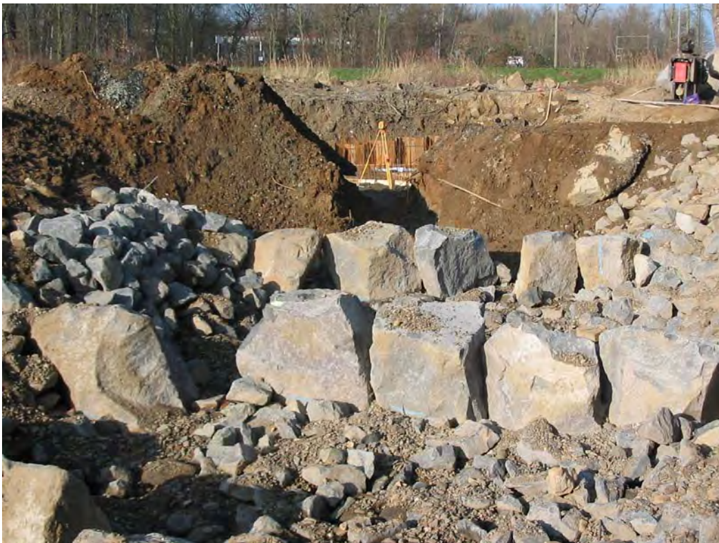
Abb. A.34: Gestaltung der rauen Sohle innerhalb eines mit Steinblöcken begrenzten Beckens während der Bauzeit.
