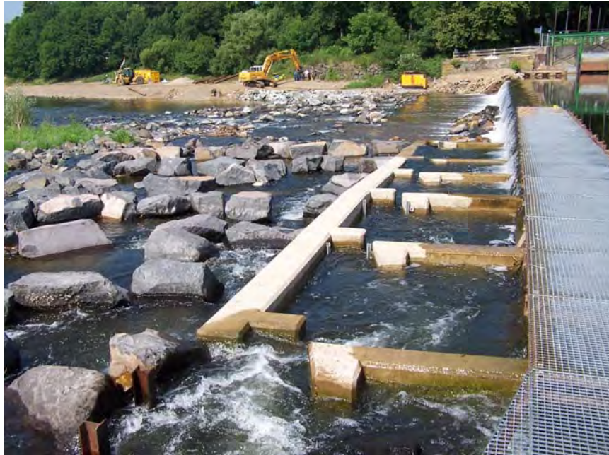
Abb. A.23 Fischaufstiegsanlage Buisdorf/Sieg, nachträglich installierter Vertical Slot Pass in der seitlichen Verschneidung. (Quelle: Nemitz)
