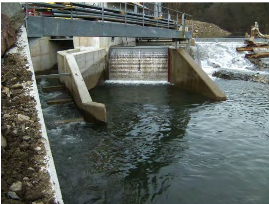
Abb. B. 10: Blick von Unterwasser auf die WKA: links die Fischaufstiegsanlage (Vertical Slot), mittig der Auslauf der Turbine, darüber die Spülklappe für Rechengut und absteigende Fische, rechts das Wehr.
