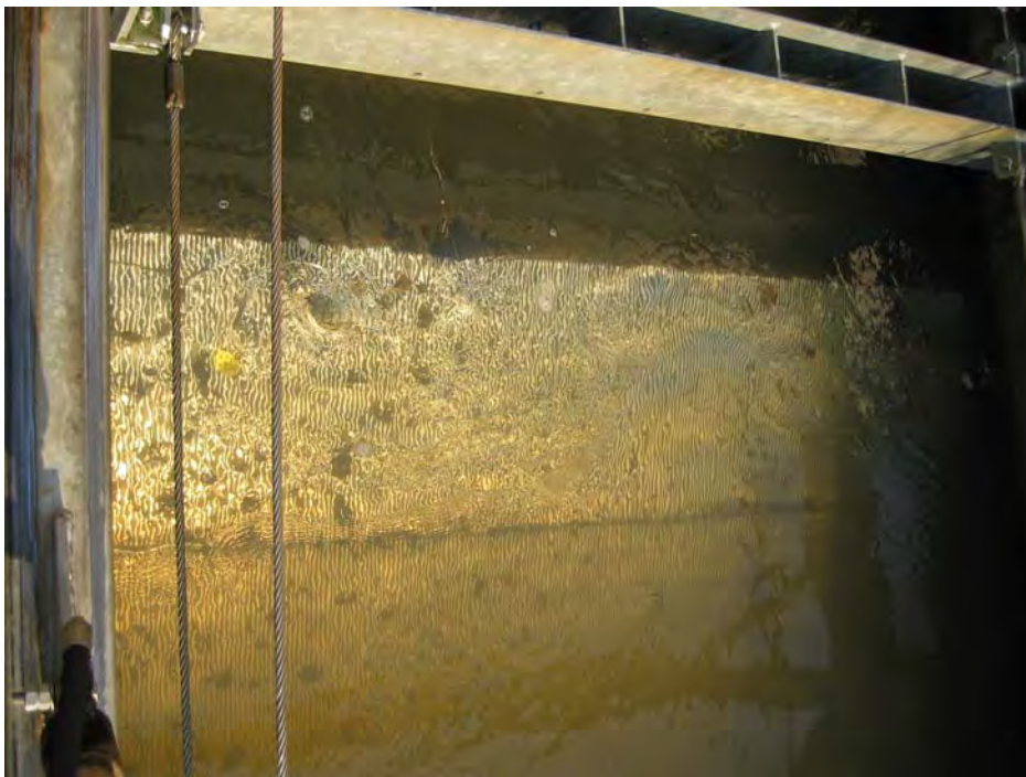
Abb. B. 6: Feinrechen in Betrieb
