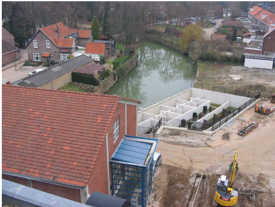
Abb. B. 16: Vertical Slot Pass an der WKA ECI-Centrale in Roermond NL / Rur
