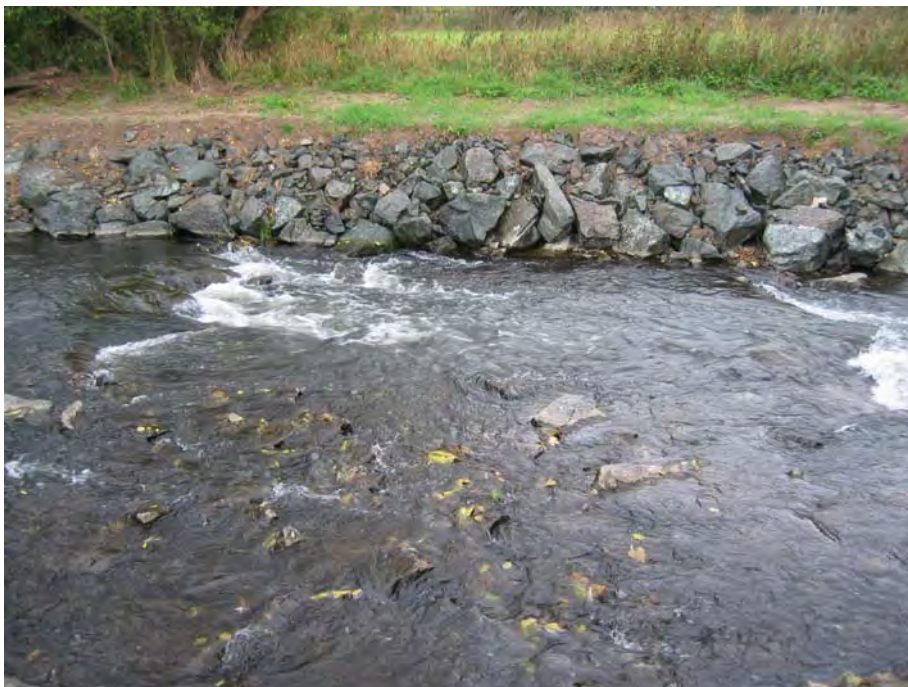
Abb. A.37: Sehr flaches, geteiltes Raugerinne mit überströmten Schwellen und geringerer Neigung zur Verklausung
