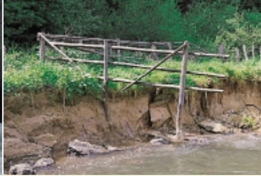
Starke Ufererosion, Platz fehlt
