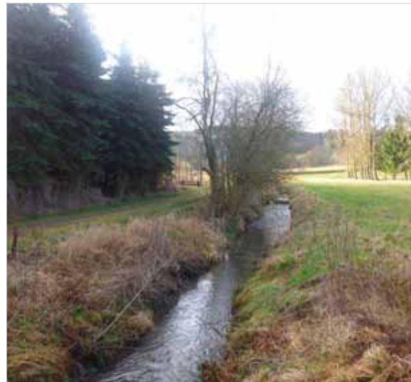
Ein trauriges Rinnsal! Der Weiberner Bach war tief eingeschnitten, eingengt und mit Rasengittersteinen ausgelegt.
