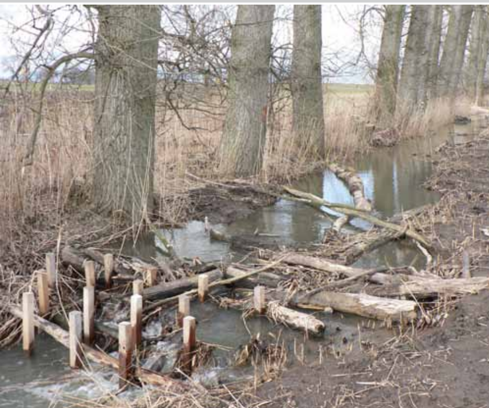
Die Pfahlfelder mit Astwerk reduzieren die Fließgeschwindigkeit und stabilisieren die angehobene Sohle.
