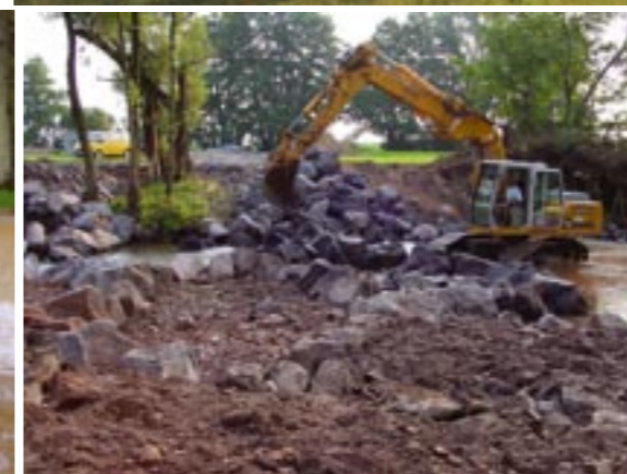
Die Wehrkrone wird abgesenkt, die verbleibende Höhendifferenz mittels einer Sohlrampe in Riegelbauweise überwunden.
