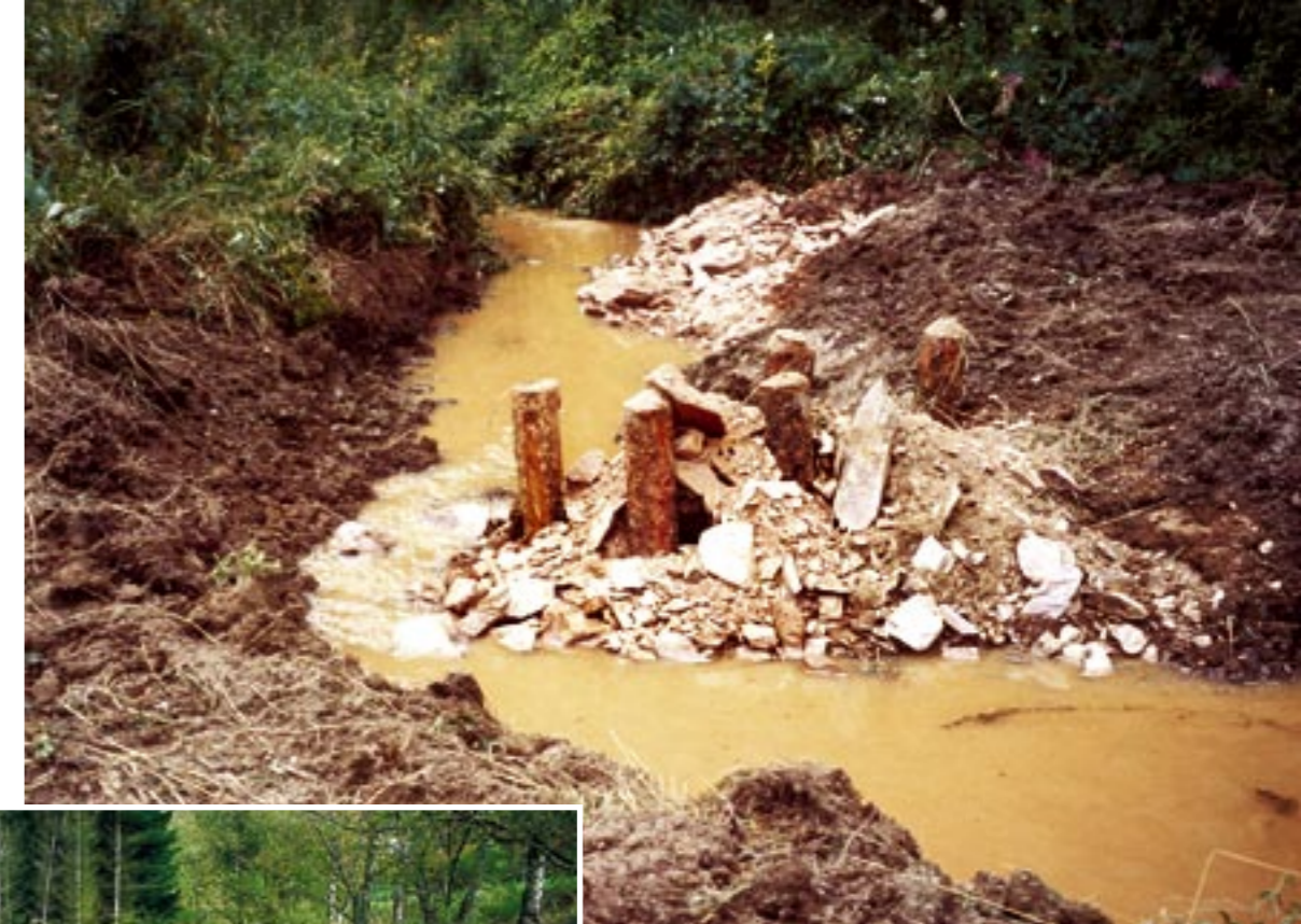
Mit Holzpfählen und Geschiebe wurde der Gewässerquerschnitt maximal verengt. Die Ufer wurden angerissen. Das Bild zeigt den Zustand während der Bauphase im Sommer 1999.
