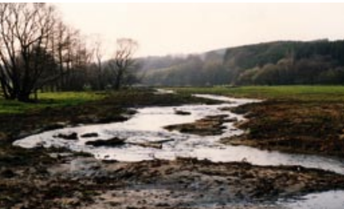
Bauphase 1996 – der Bach erhält ein neues Bett. Die Trasse wird vor Ort abgesteckt, die Laderaupen zeichnen eine 680 m lange und 8 bis 12 m breite Mulde vor.
