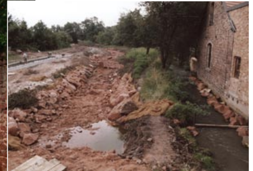
Uferbefestigungen wurden entfernt, das Profil aufgeweitet; abschnittsweise wurde das Ge- wässerbett verlegt.
