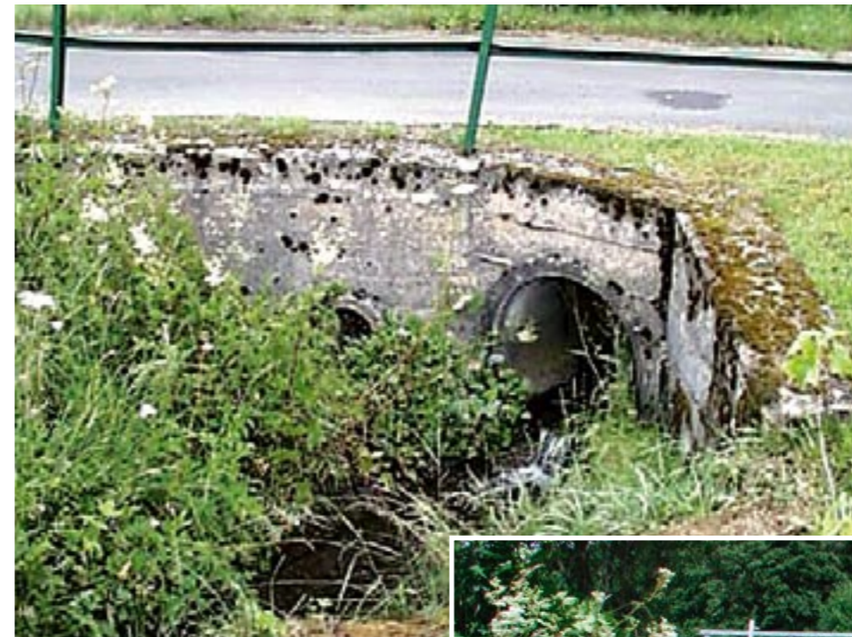
An einem Nebengewässer der Lieser in der Gemarkung Beinhausen befand sich auf einer Strecke von ca. 40 m eine Betonmauer und eine Befestigung in der Gewässersohle (ehemalige Rübenwäsche). Anschließend querte der Bach einen Wirtschaftsweg mit einem Rohrdurchlass NW 700. Ein weiterer Durchlass NW 300 sorgte für die Ableitung des in der angrenzenden Fläche anfallenden Oberflächenwassers.
