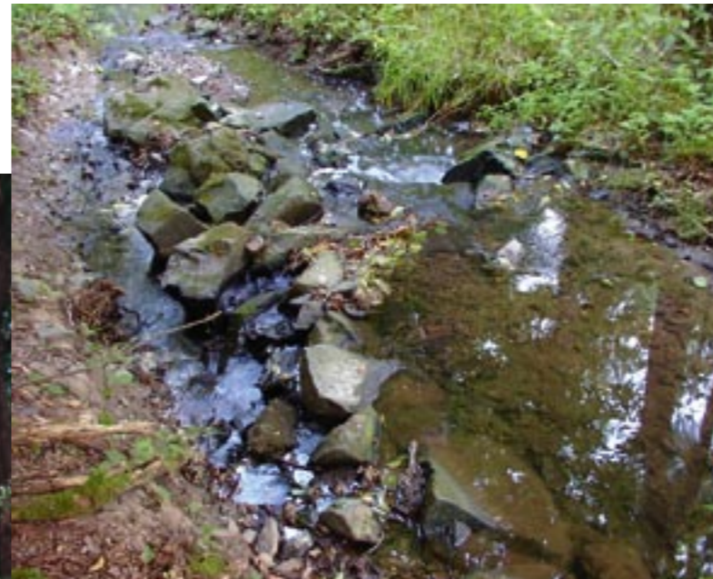
Die Querriegel wurden aus Wasserbausteinen geschüttet und mit bindigem Boden verfüllt, so dass sie eine dichte Sperre bilden. In den Bereichen zwischen den Querriegeln wurde das alte Bachbett aufgefüllt.
