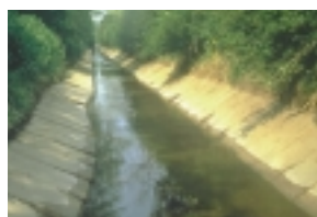
Güteklasse 7: übermäßig geschädigt
