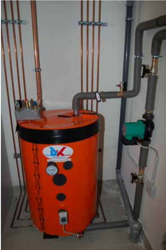
Abb. 7: Neuer Wärmetauscher zur Kompressorabwärme-Rückgewinnung
