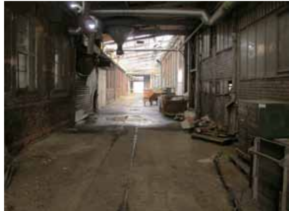
Abb. 46: Schlechter Erhaltungszustand von ehemaligen Produktionsgebäuden auf dem Pfaff-Werksgelände in Kaiserslautern (Foto C. Schladt; 2.11.2010)
