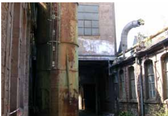
Abb. 45: Schlechter Erhaltungszustand von ehemaligen Produktionsgebäuden auf dem Pfaff-Werksgelände in Kaiserslautern (Foto K. Brand; 15.04.2009)
