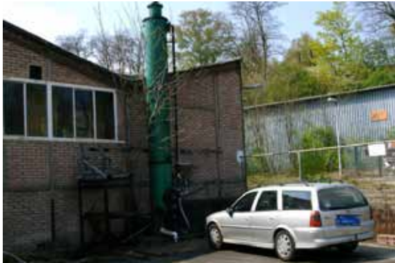
Abb. 44: Strippkolonne zur Abreinigung von LCKW-belastetem Grundwasser auf dem Pfaff-Werksgelände in Kaiserslautern (Foto K. Brand; 15.04.2009)
