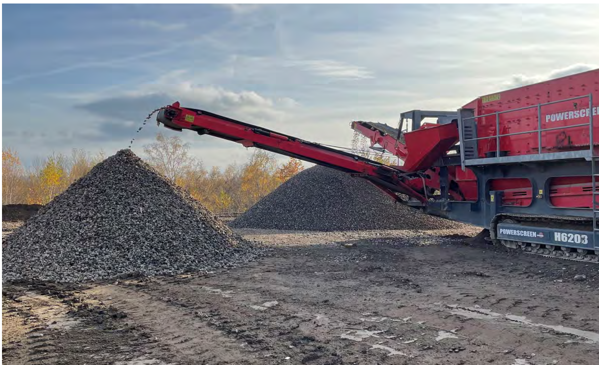
Zur Baustoff-Recyclinganlage der Mendiger Basalt gehört auch eine Siebmaschine für Bauschutt.
