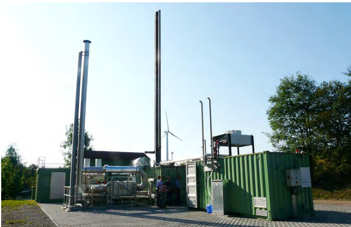
Entgasungsanlage einer Deponie
