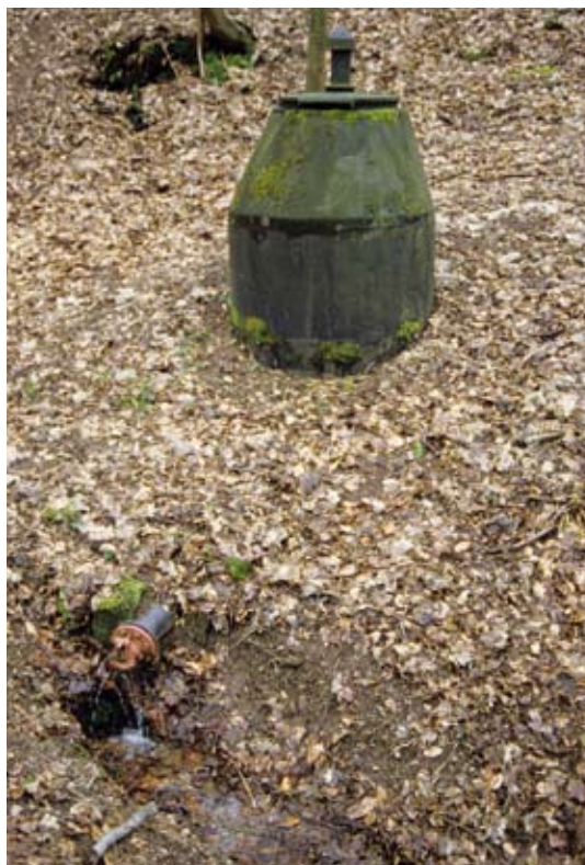
Typen von Quellfassungen: Brunnenstuben mit und ohne Überlauf.
