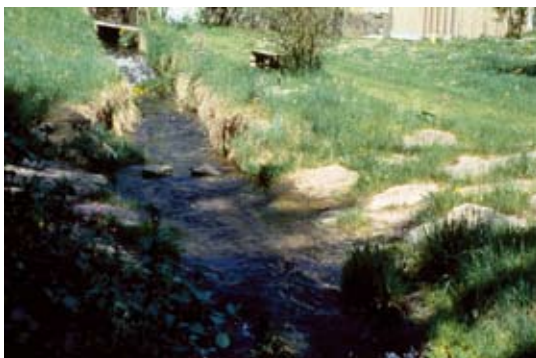
Die Umwandlung einer Verrohrung zu einer offenen Furt ist eine zentrale Maßnahme des Quellschutzes.
