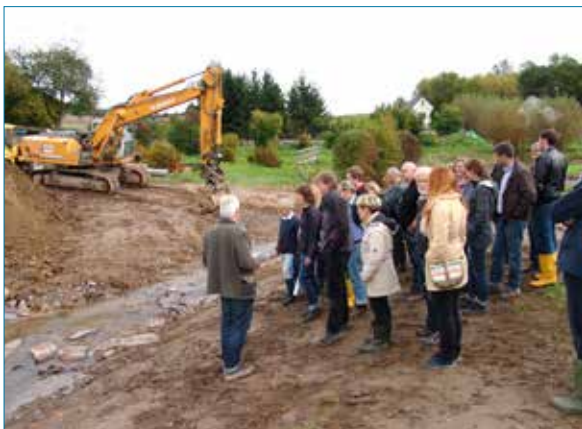
Der Planer erläutert den Teilnehmern der Gewässer-Nachbarschaft Polch die Renaturierungsmaßnahme am Ruitscher Bach
