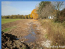
Anhebung der Gewässer - Sohle Ophogen bodem van de beek Raising the bed of the stream
